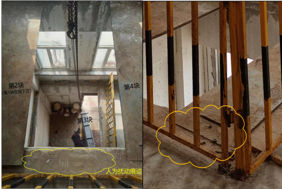
图 6 吊装孔盖板搭接处人为扰动情况
