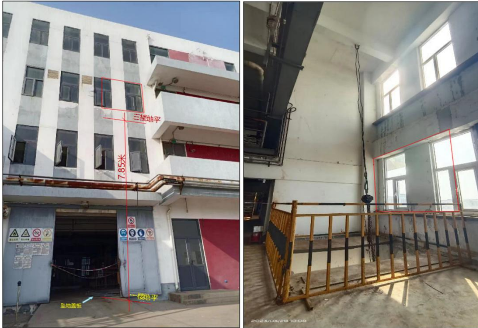
图 1 事故现场建筑物情况
