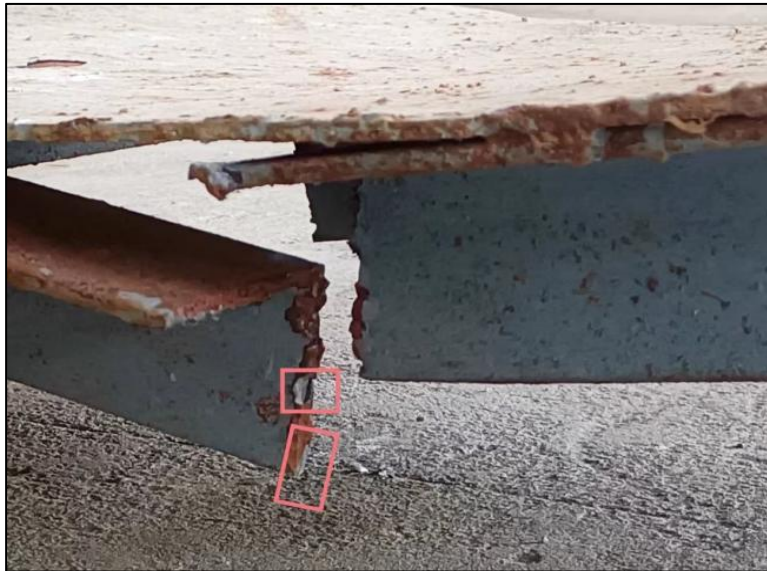
图 4 A 侧角钢焊口开焊情况
