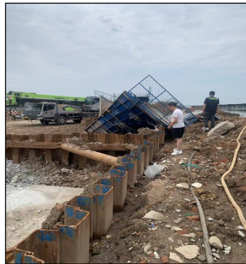
图 13 实际发生事故现场图
